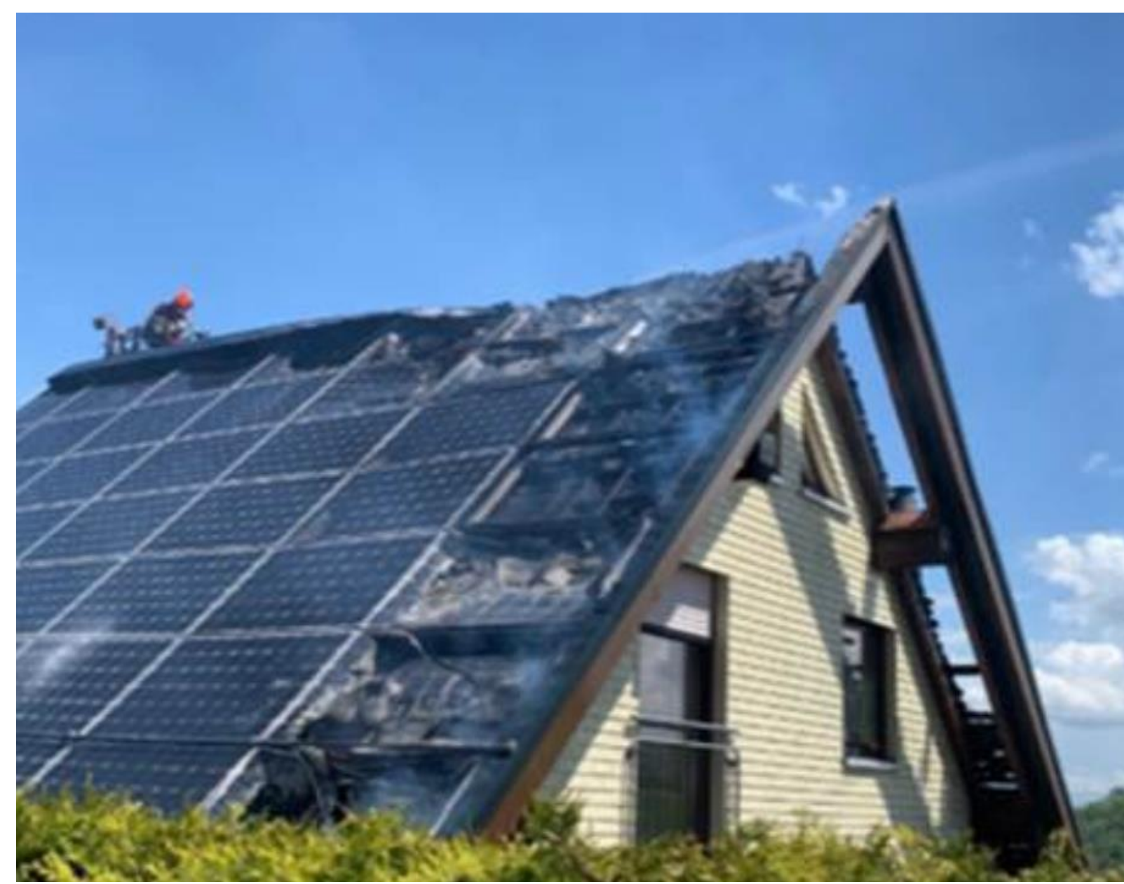
Der häufigste Fall in der Schweiz: Ein Hausbrand zerstört eine PV Anlage. Foto: GVB 2021 / Wolfisberg.
