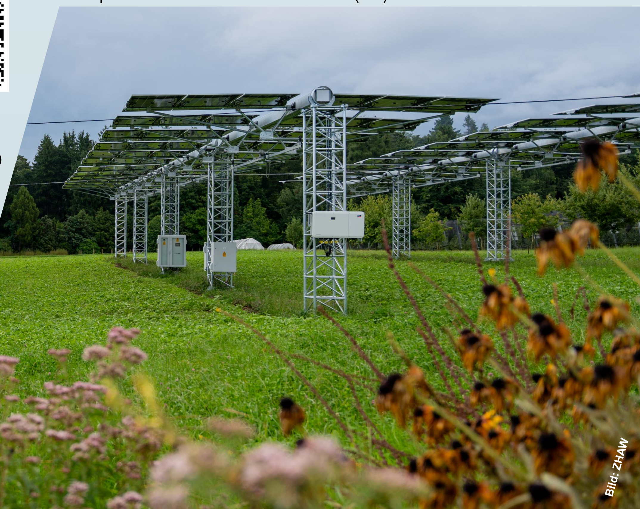
Abb. 6: Zweiachsig nachgeführte Agri-PVA (151 kWp) von Remtec auf dem Campus Grüental der ZHAW Wädenswil (CH)
